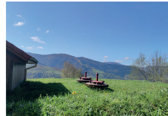
La ressource en eau potable : travaux de recaptage et amélioration du réseau existant à Bussang
