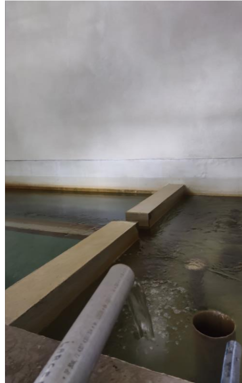
Captage et réservoir, Bussang
