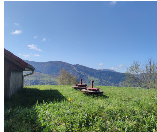
La ressource en eau potable : travaux de recaptage et amélioration du réseau existant à Bussang
